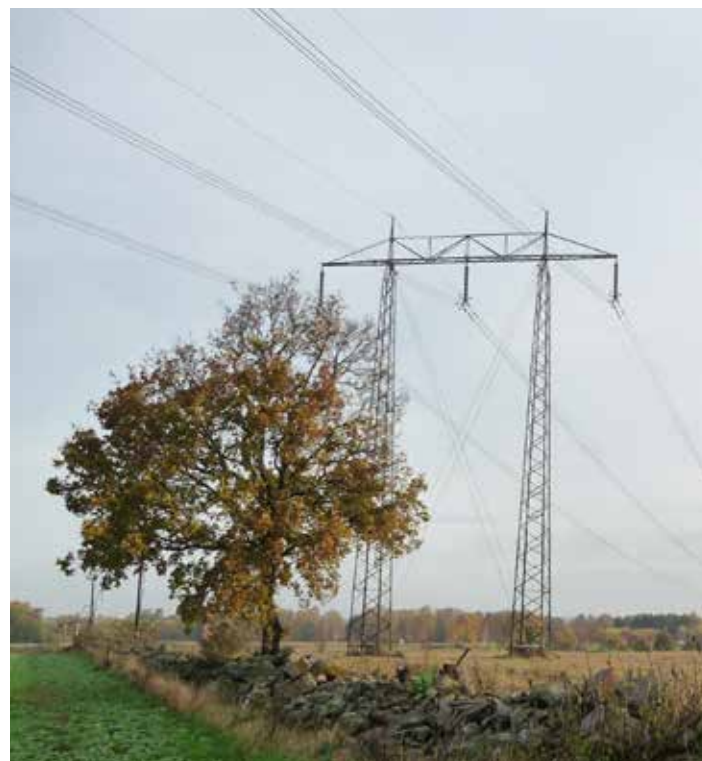
400 kV ledningar strax väster om Hörby tätort.
