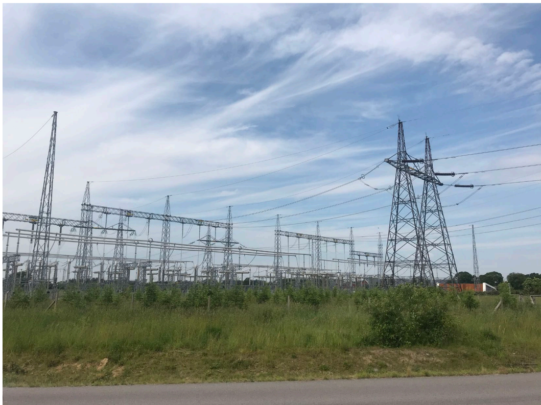
Figur 7: Foto över befintliga kraftledningar och ställverk på Hurva station i Lyby.
