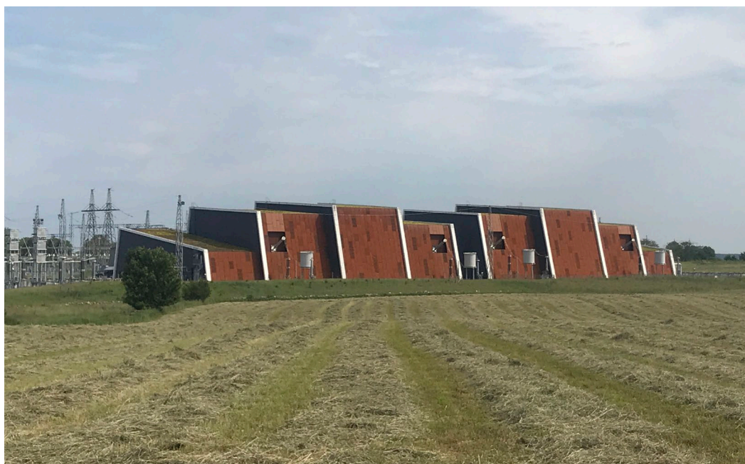
Figur 3. Fotot visar befintlig omriktarstation "Hurva station" i Lyby. Fotot är taget från sydväst med ställverk och kraftledningar i bakgrunden. Byggnaden har en hög ambitionsnivå i utformningen t.ex. i form av materialval och olika byggnadsvolymer. Den nya stationen är tänkt att hålla en lika hög ambitionsnivå som befintlig.
