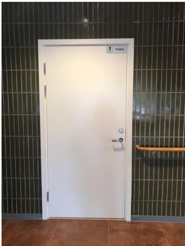
Dörr till wc med bristande skyltning
