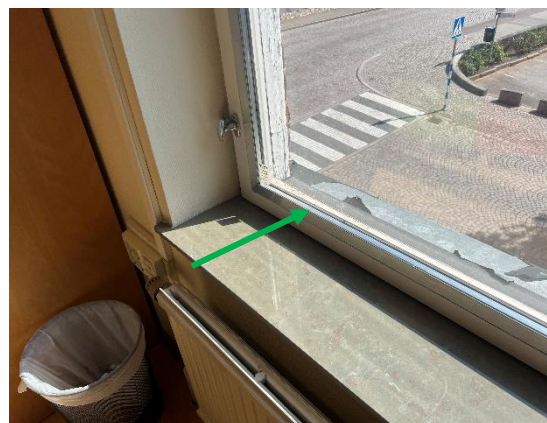
Figur 15. Prov 8. Isolerglas från 1978 har satts in i äldre träfönster del från 1884, ej PCB/klorparaffiner. Inga fogar noterades på insidan.
