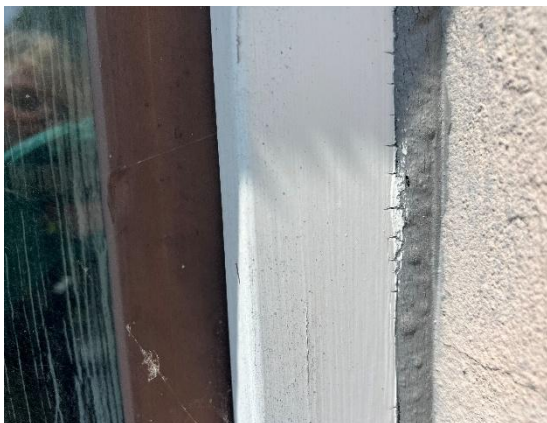
Figur 12. Prov 14. ny (1978?) grå mjukfogar som fanns runt några källarfönster, den innehåller ej PCB men klorparaffiner.
