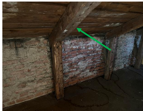
Figur 17. Prov 3. på bjälkar och träspont från vinden, materialet är ej impregnerat.
