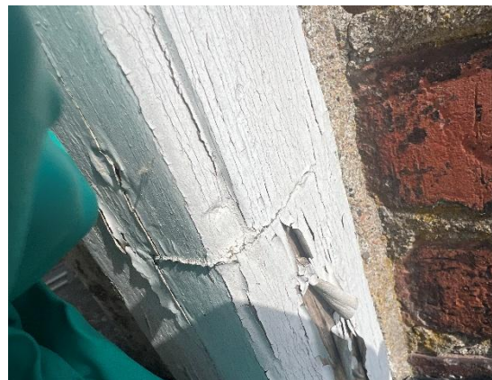
Figur 13. Runt nästan alla fönster i delen från 1884 noterades bara bruksfogar runt fönster.
